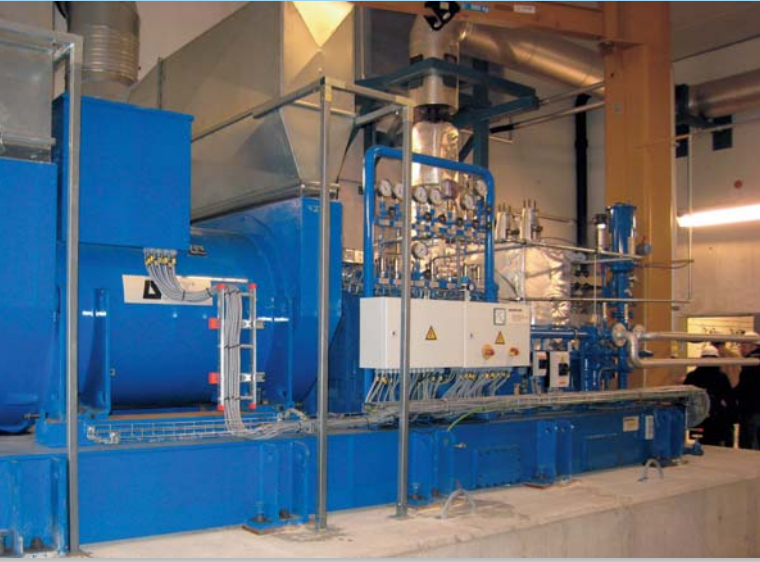
Fra produksjonshallen i kraftvarmeverket
